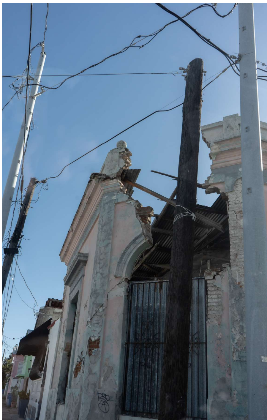
Imagen 20. Estructura con daños visibles. Foto por GMT,LLC 2025.
