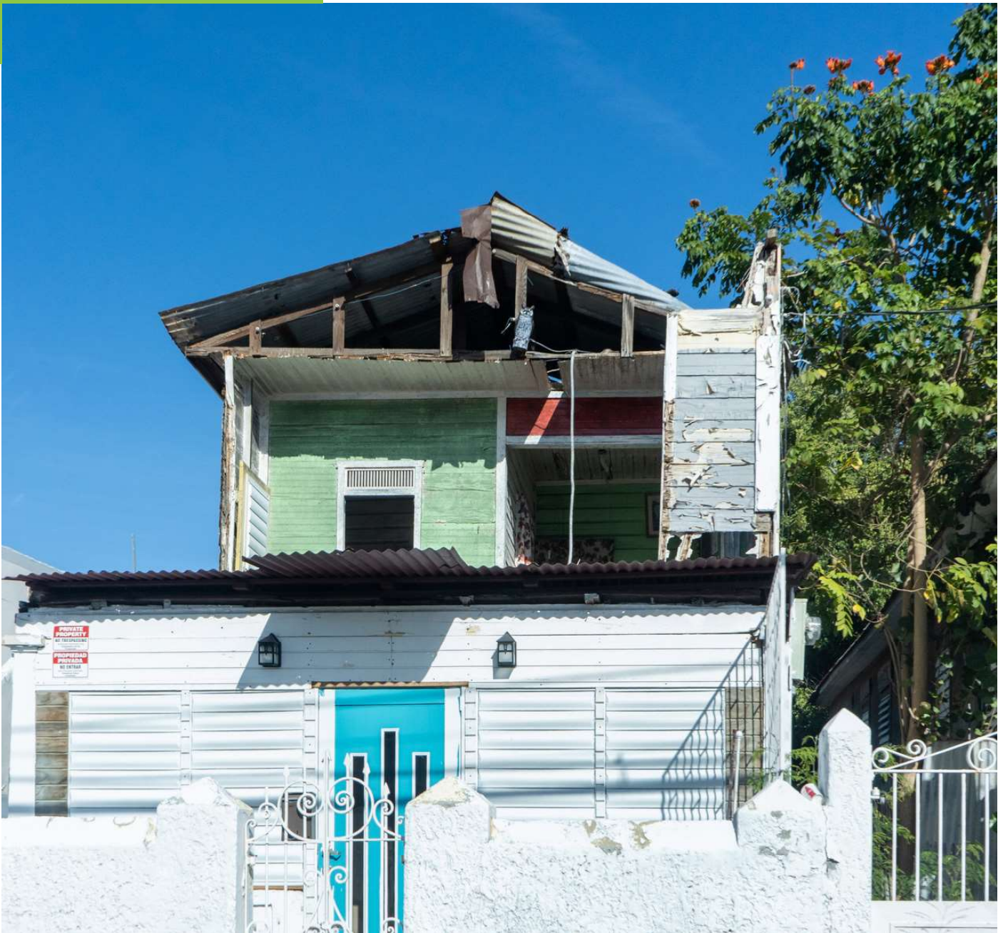
Imagen 12. Vivienda deteriorada en Bélgica. Foto por GMT, LLC 2025.
